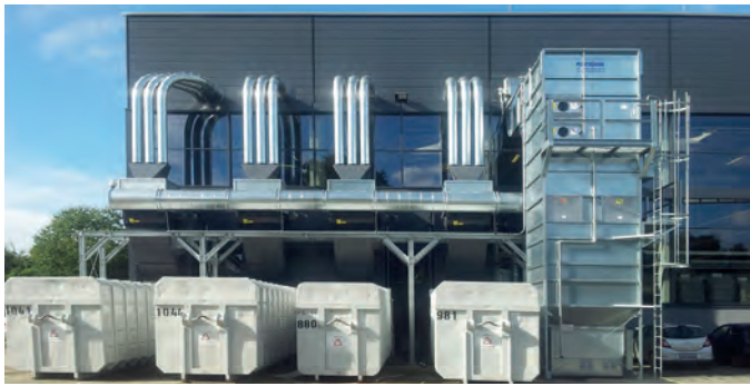
MultiStar-Filteranlage Typ JP 5/5 mit Höcker Materialabscheidern und Containerpressen
