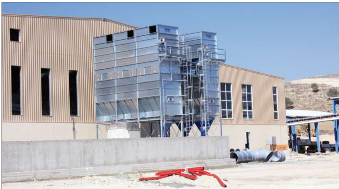
Zwei von insgesamt 5 Filteranlagen des Typs MultiStar in druckstoßfester Bauweise kurz vor Fertigstellung. (Foto: Höcker Polytechnik)
